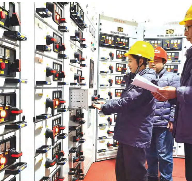
湖北恩施水电公司开展电站“黑启动”应急演练
