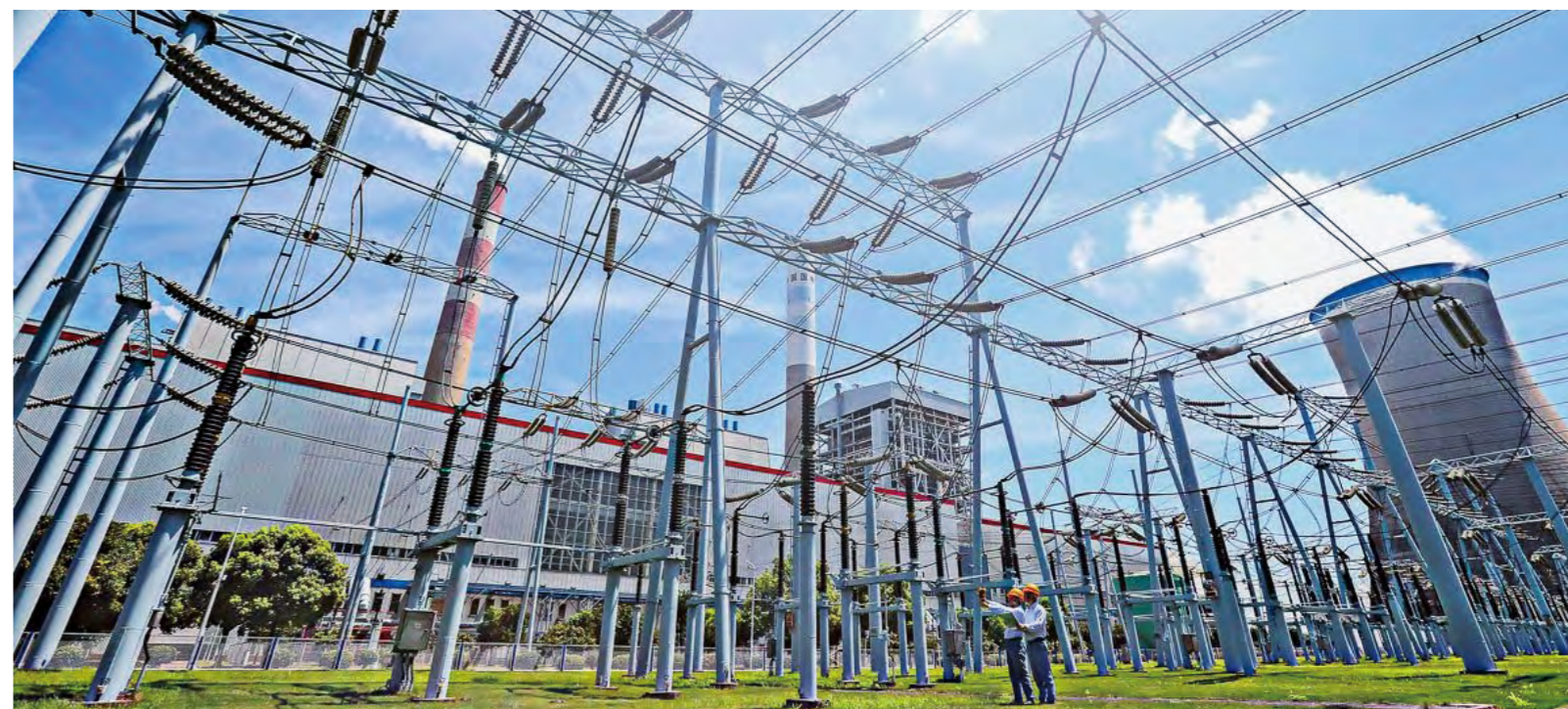
江西九江发电公司员工在烈日下巡检 220 千伏升压站，确保电力输送安全高效
