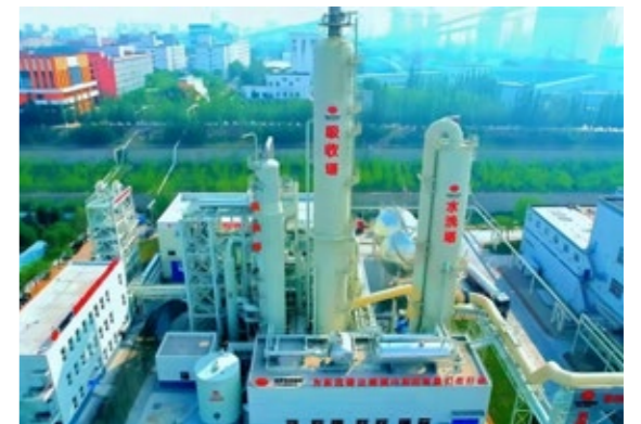
中国最大规模燃煤电厂燃烧后 CO 2 捕集示范装置
