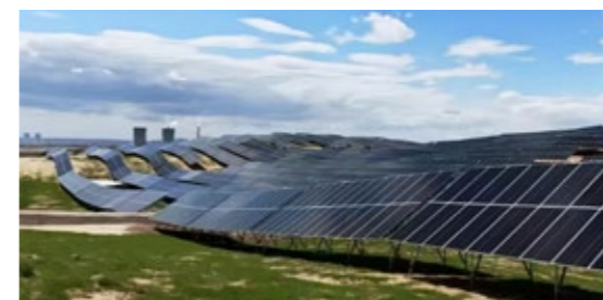
“风光”大基地——宁夏宁东复合光伏基地项目
