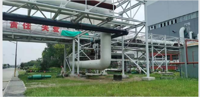
工业供气增容机组管网
